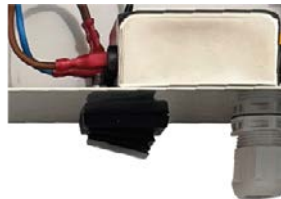
Fig. 12: Interruptor de encendido y apagado
